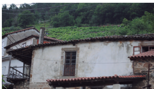
Restos de encalado liso tradicional dejando a la vista la cantería trabajada (esquinas dinteles y jambas).
