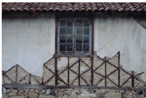
Falseado de sillares sobre el entramado de tierra en la fachada oeste.
